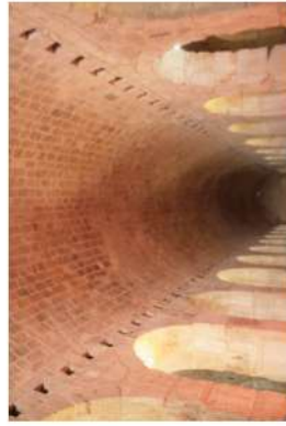
لوحة (٨٨) قبو نصف برميلي في المصلى المروحي Parker, 1995, 314; Fleming Et, 1991, 462 977 Fleming Et, 1991, 462 978 نظر المصالح الجديا في هذه الزاوية Fleming Et, 1991, 127, fig. 40; 462 980 Parker, 1995, 315 981
