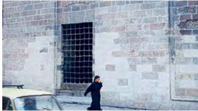
مسجد شيخو - الصليبية: إستبدال خاطئ لأحجار الواجهة
