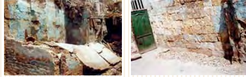
حوض شرب الدواب إزالة دورة المياه الملاصقة للمبنى التي تضر إضراراً جسيماً بالمبنى
