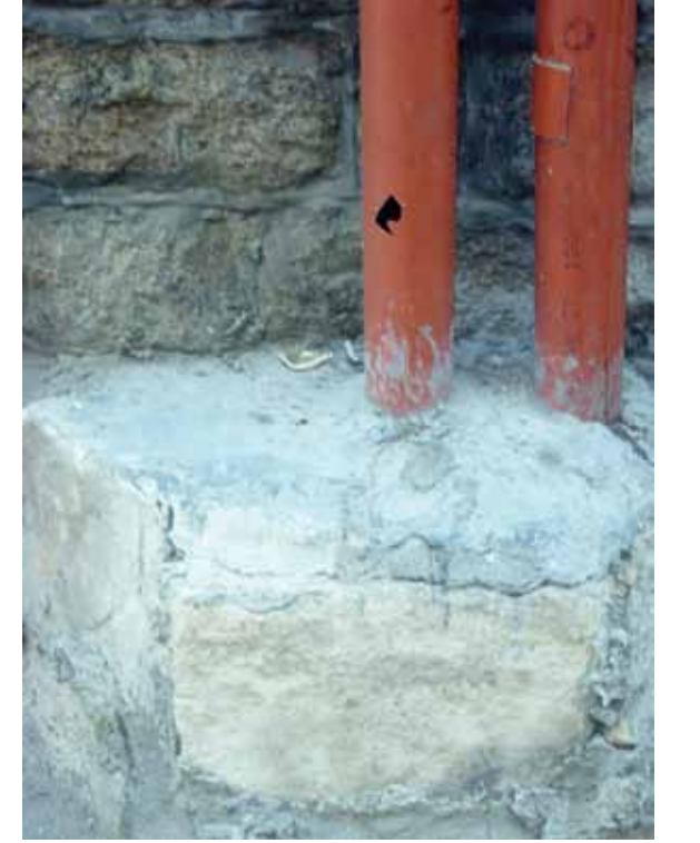
صورة (1.9): الخطوط المهترئة لشبكة الصرف الصحي
